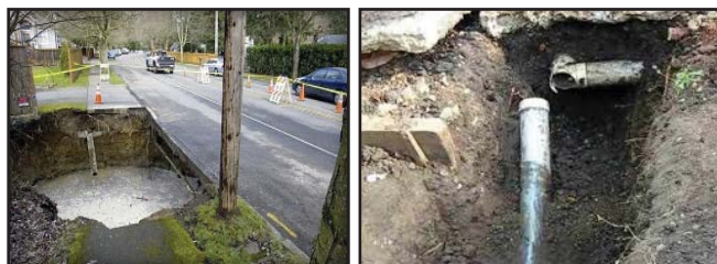
تصویر ۱۰. شکست لوله آب ناشی از بروز پدیده فرونشست در خاک زیرین
