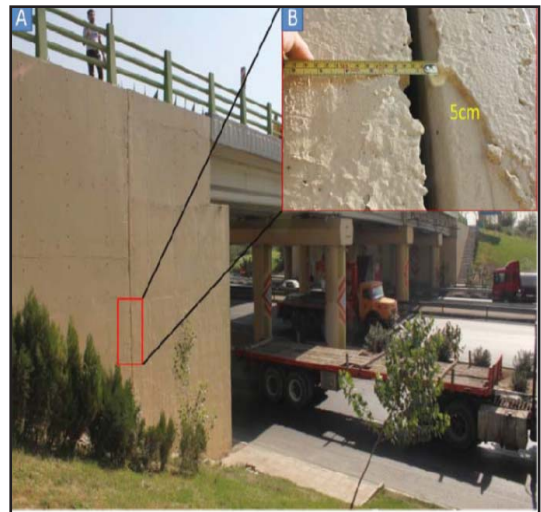
تصویر ۲۹. بروز ترک‌های برشی ناشی از فرونشست زمین در پل آزادگان ( تقاطع بزرگراه شهید رجایی)
