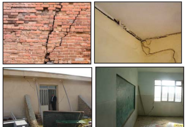
تصویر ۱۱. بروز ترک‌های برشی در ساختمان در اثر فرونشست خاک زیر پی در منطقه مورد مطالعه
