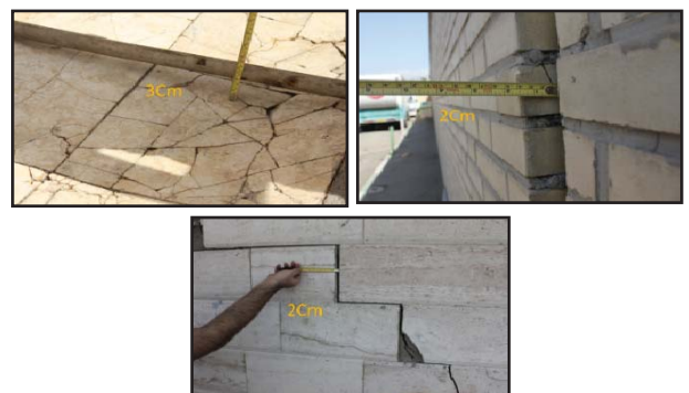
تصویر ۱۲. پایین رفتن کف طبقه و بروز خردشدگی در سنگ کف منزل مسکونی و ایجاد اختلاف سطح در دیوار بین دو منزل مسکونی ناشی از بروز فرونشست در منطقه مورد مطالعه
