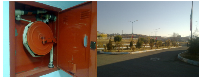
شکل ۴: نمایی از فضای باز محوطه و سیستم اطفاء حریق بیمارستان به منظور استفاده در هنگام وقوع بحران
