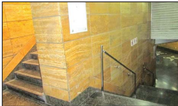
شکل ۹. شکستگی ناگهانی در مسیر ارتباطی بین سالن فروش بلیت و فضای بیرونی
