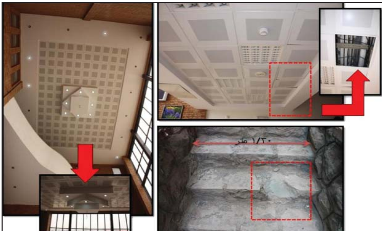
تصویر ۲. سقف های کاذب و شکست های موجود در کف پله ها
