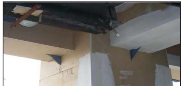
شکل ۳: بوردها و پنل های ضد حریق
