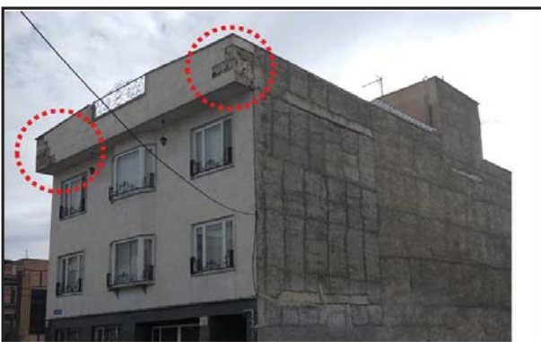
تصویر ۲۱: امکان سقوط اجزای نمای ساختمان در زلزله
