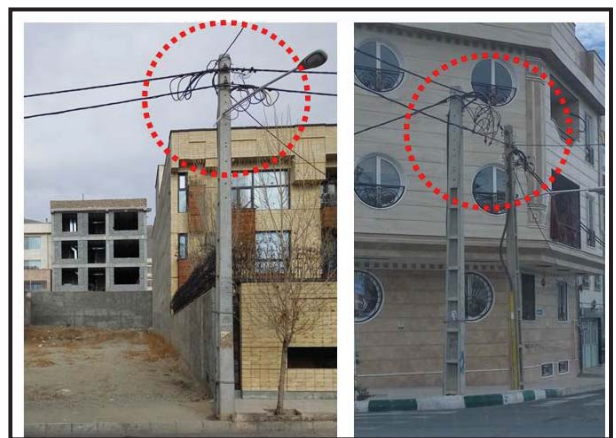
تصویر ۱۷: آسیب‌پذیری برخی سیم‌ها و کابل‌های برق
