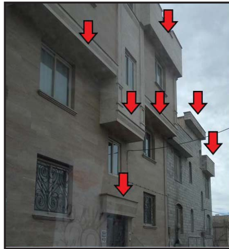
تصویر ۲۲: امکان ریزش جان‌پناه‌ها، تراس‌ها و سایر بیرون‌زدگی‌های ساختمان در زلزله
