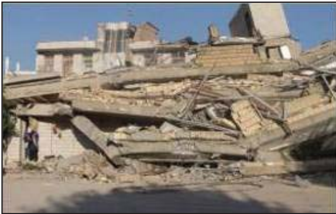
شکل ۴: فروریزش کامل یک ساختمان بتن آرمه در محله فولادی (قسمت غربی شهر سرپل ذهاب) ناشی از کمبود آرماتور عرضی (خبرگزاری ایسنا، ۱۳۹۶).
