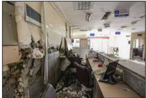
شکل ۶: آسیب شدید زمین‌لرزه به بیمارستان تازه تأسیس سرپل‌ذهاب، شش ماه پس از افتتاح (خبرگزاری مشرق، ۱۳۹۶)
