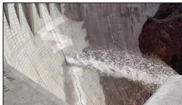
شکل ۱۰. نمایی از ترک خوردگی سدها و پلها که با استفاده از حسگرهای فیبری قابل شناسایی هستند (اینائودی، کاتون، فیگینی و سا ۳ ، ۲۰۱۳)
